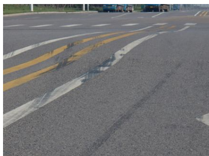
图5 2010年4月份道路波浪变形 Fig.5 Settlement of road in April, 2010
